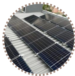
panele fotowoltaiczne na dachach
